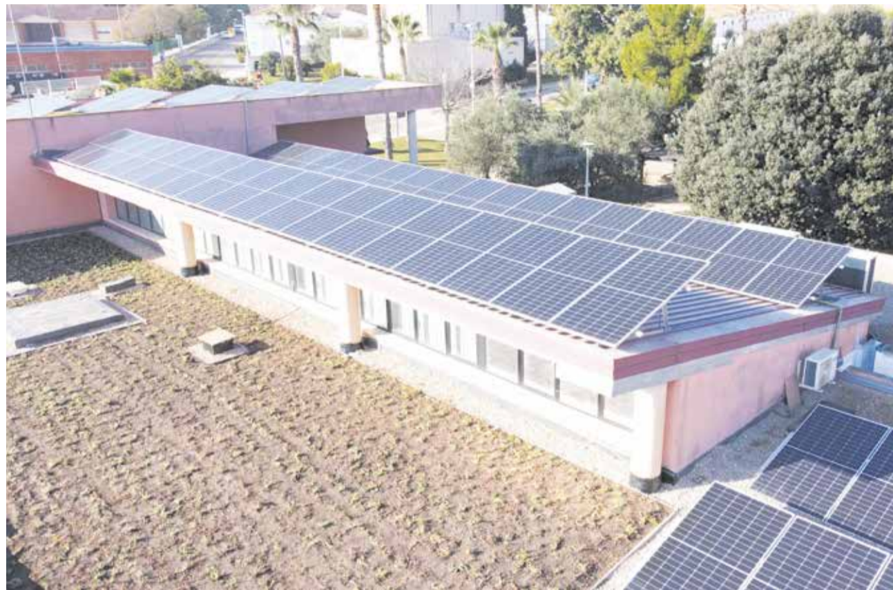
Placas solares instaladas en el almacén de servicios municipales de Picassent ./ EPDA
