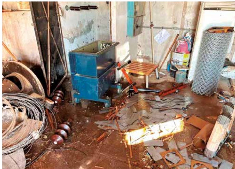
Los daños producidos en una caseta de riego. / EPDA
