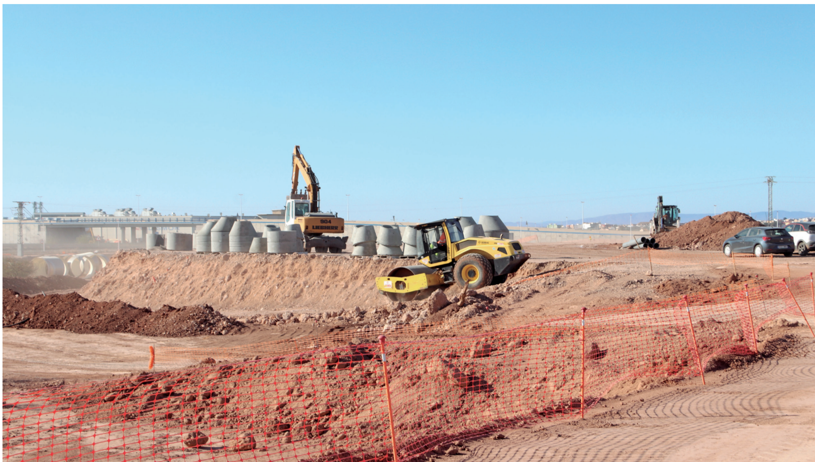
Inicio de las obras de la plataforma intermodal de Sagunt. / BORJA PEDRÓS
