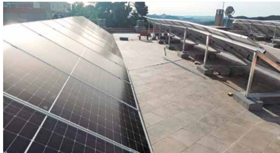
Placas solares instaladas en edificios públicos de Macastre. / EPDA
