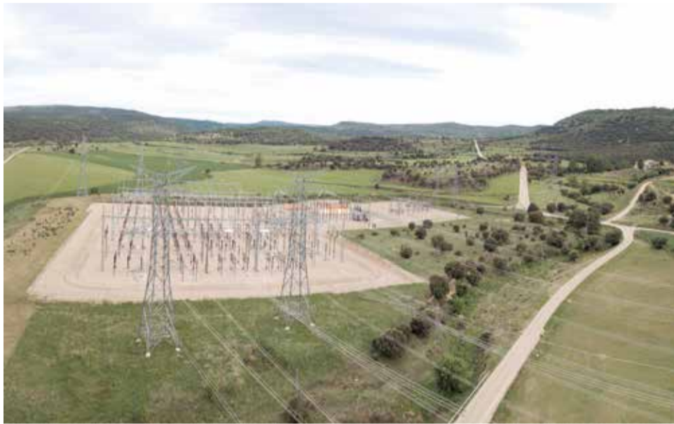
Subestació transformadora de Fraiximeno en Morella. / EPDA
