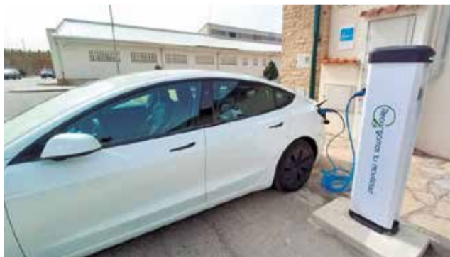
Nou punt de recàrrega de vehicles elèctrics. / EPDA
