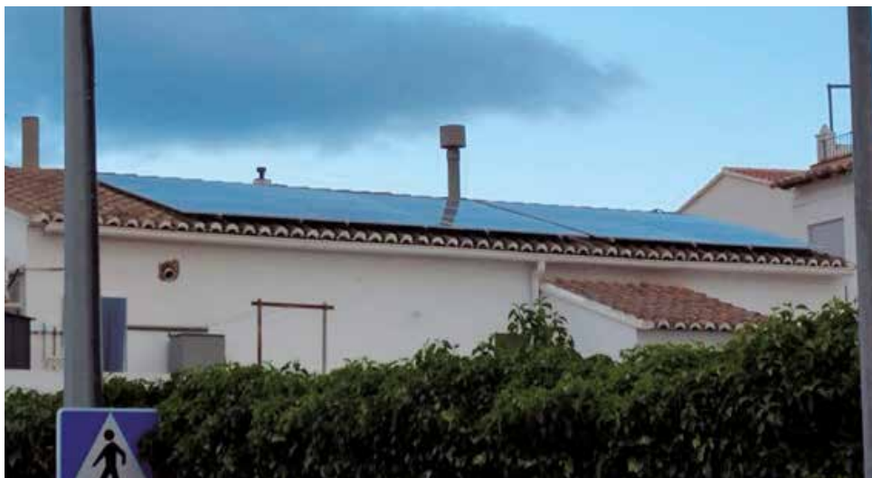
Instalación fotovoltaica en la escuela infantil de Titaguas. / EPDA
