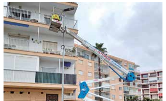
La instal·lació de les càmeres. / EPDA
