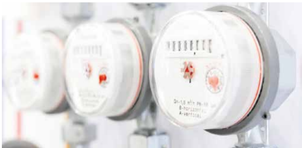
Comptadors de telectura d'aigua potable. / EPDA
