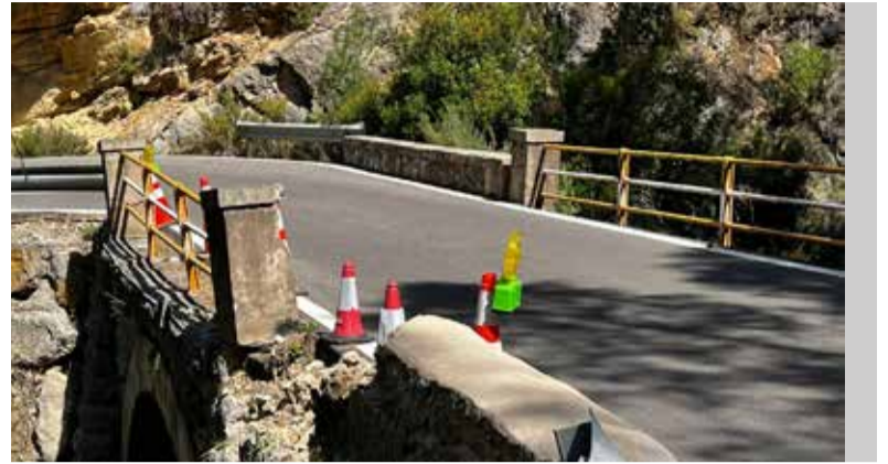
Estado de la carretera en el punto indicado. / EPDA
