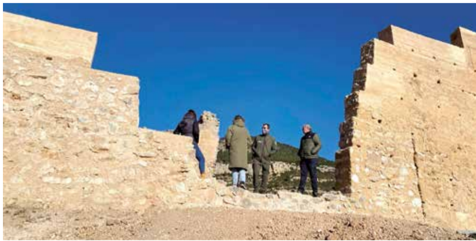
El Castillo de Chera en una de las fases de rehabilitación / EPDA
