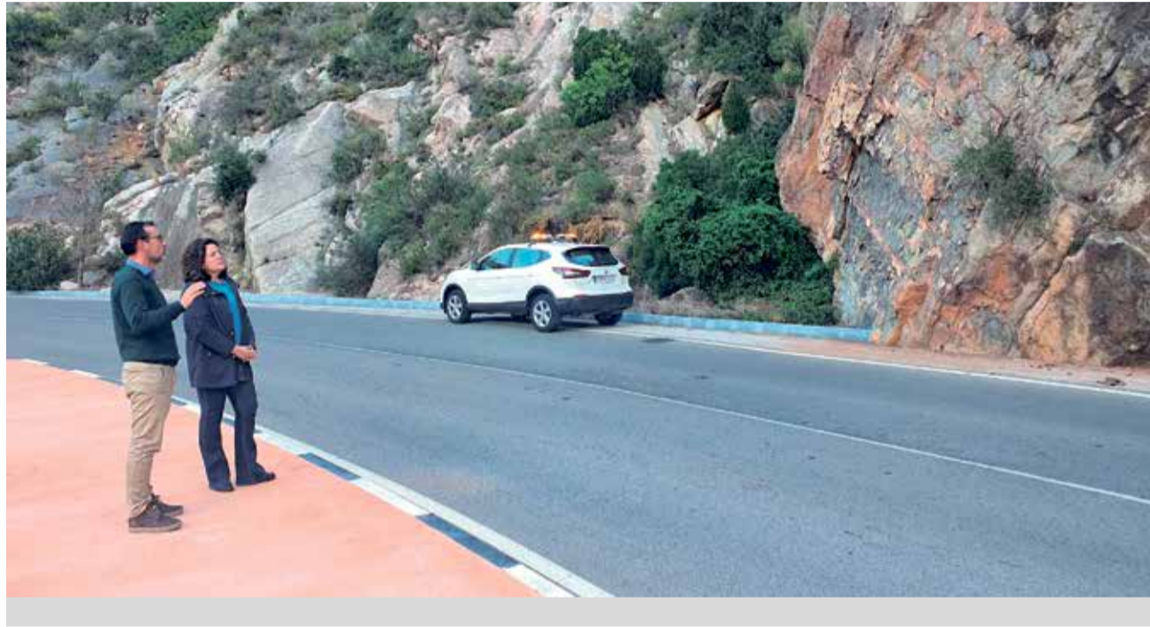
Visita de la directora general d'Infraestructures, M. José Martínez Ruzafa, a la CV-230. / EPDA
