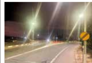
Les llums instal·lades. / EPDA
