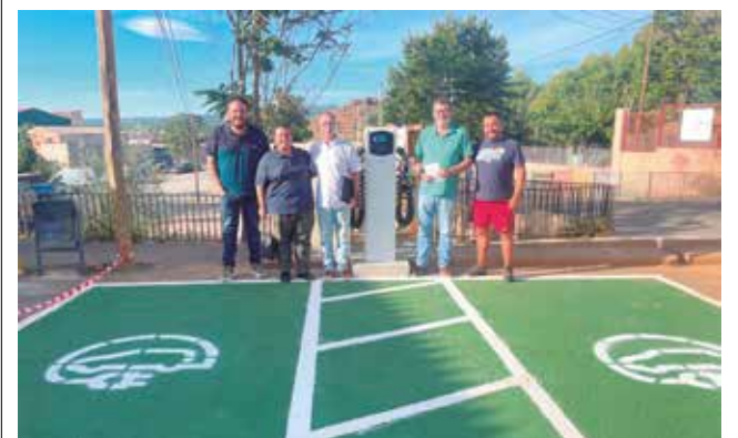
Primera estación de carga de Pedralba. / EPDA
