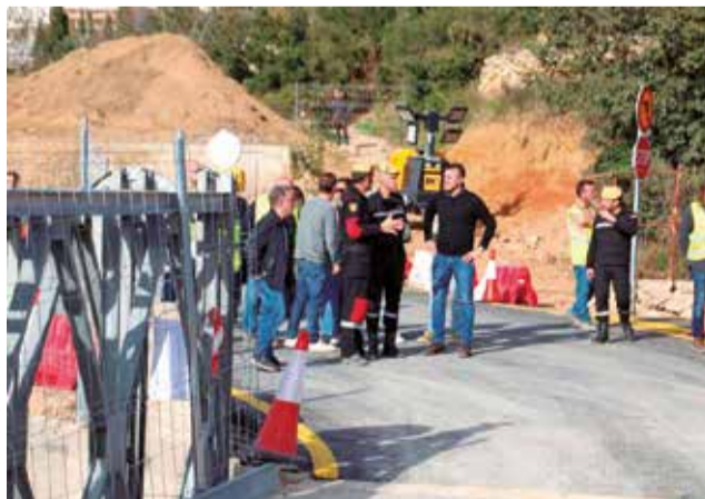
Uno de los puentes de Buñol afectados. / EPDA
