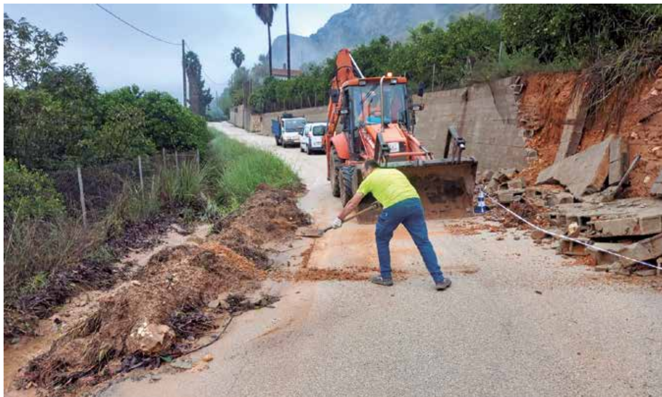
Diferentes actuaciones en los caminos agrarios que quedaron devastados tras la DANA. / EPDA
