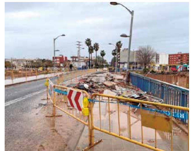
Un carril cortado del puente. / EPDA
