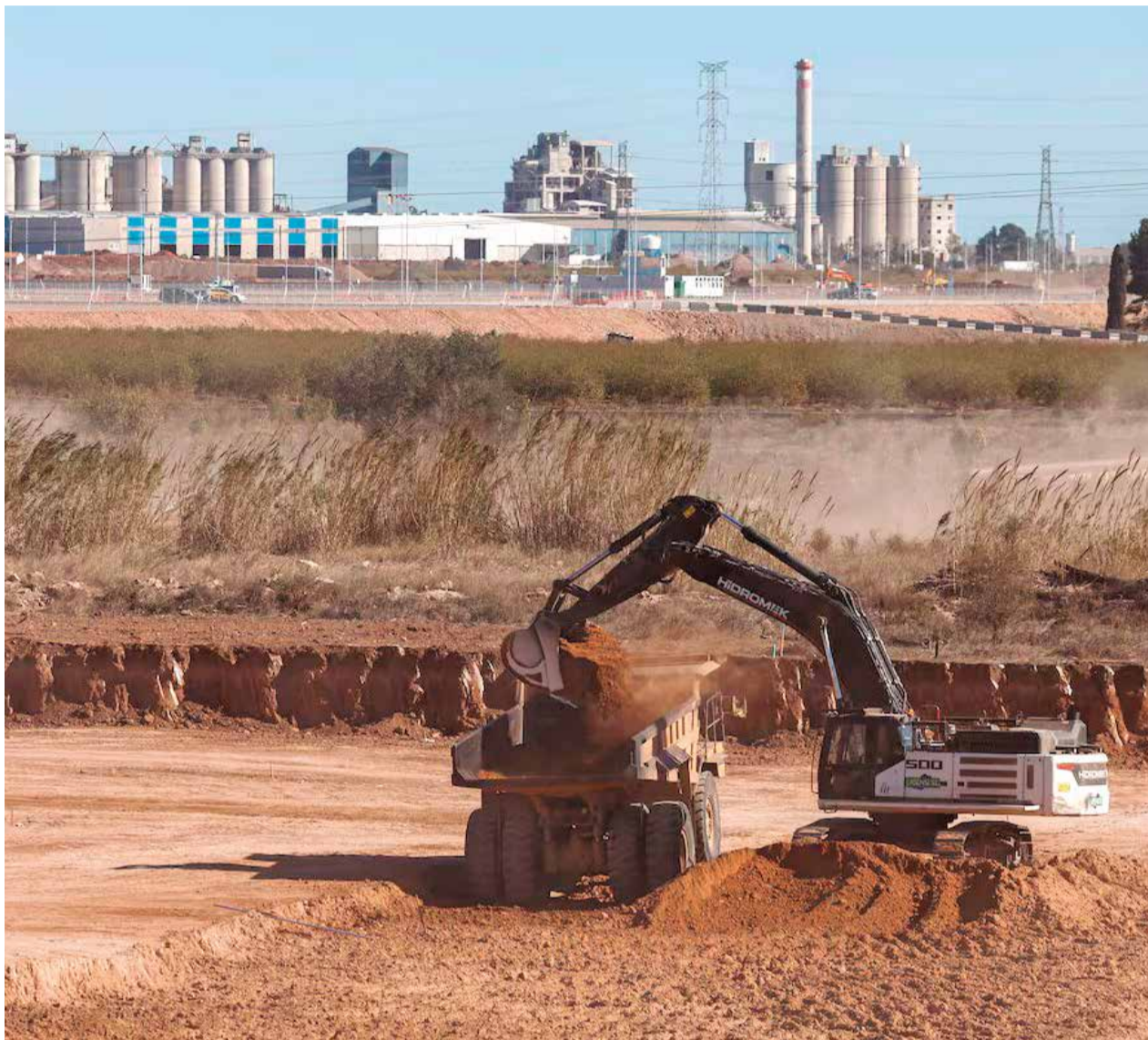
Obres de construcció de la Plataforma Intermodal a Parc Sagunt II. / EFE
