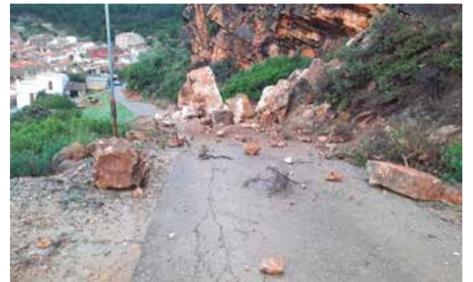
Daños causados en Fanzara por las lluvias. / EPDA
