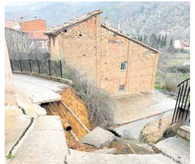
Derrumbe en Casas Bajas. / EPDA
