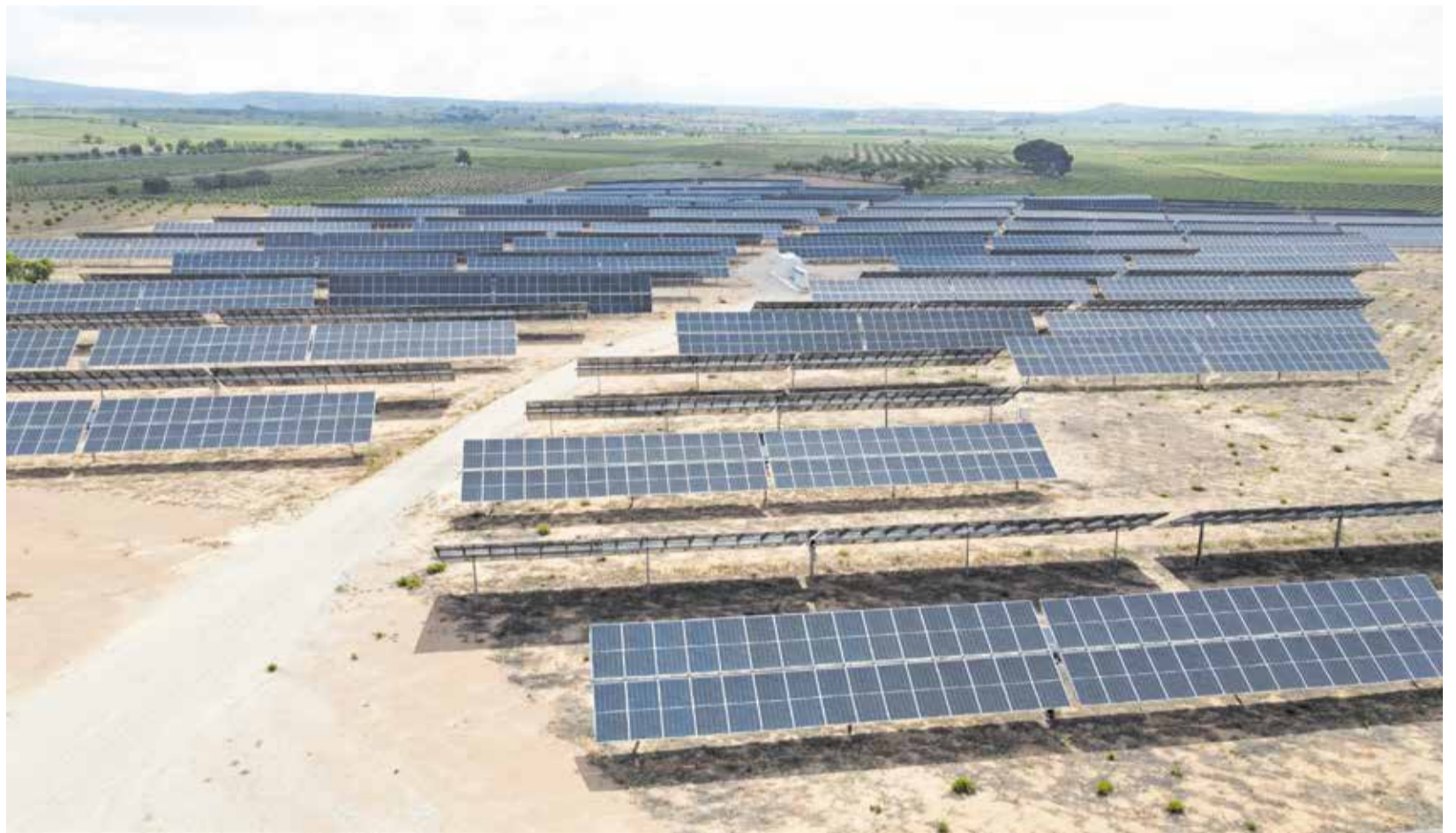
Vista aérea del parque fotovoltaico 'Luzem-San Antonio', ubicado en Requena. / EPDA
