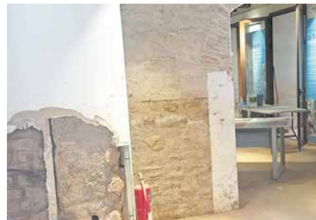
Los daños en el MUPA. / EPDA
