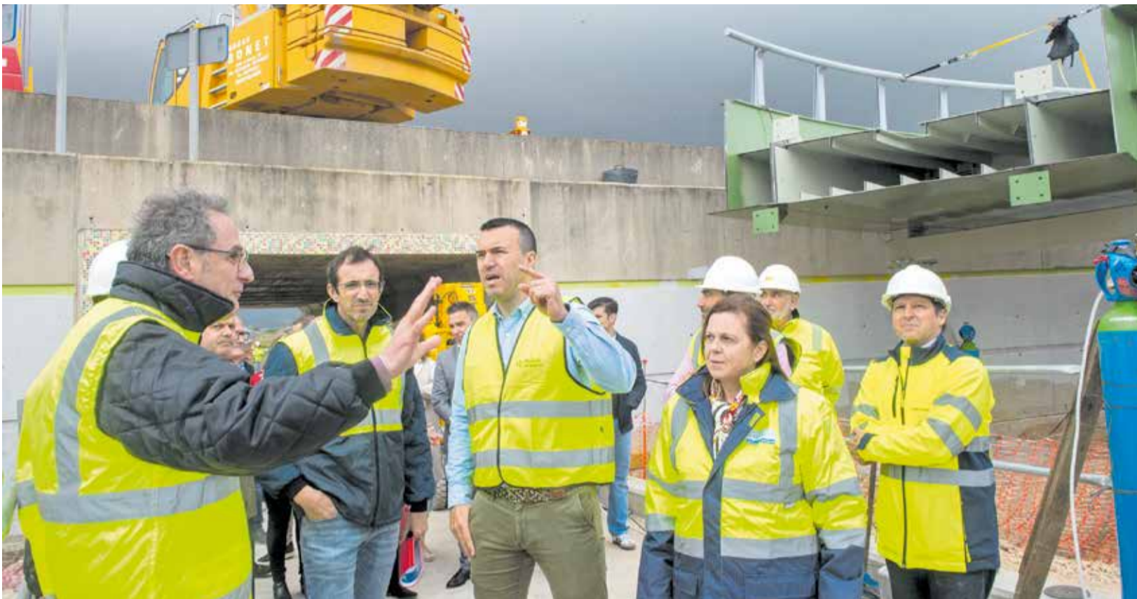
Tècnics i autoritats provincials i municipals visiten les obres de la passarel·la ubicada entre Sueca i Fortaleny. / EPDA
