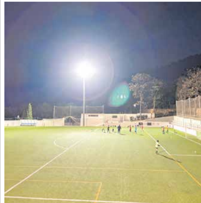
El camp amb la nova il·luminació. / EPDA
