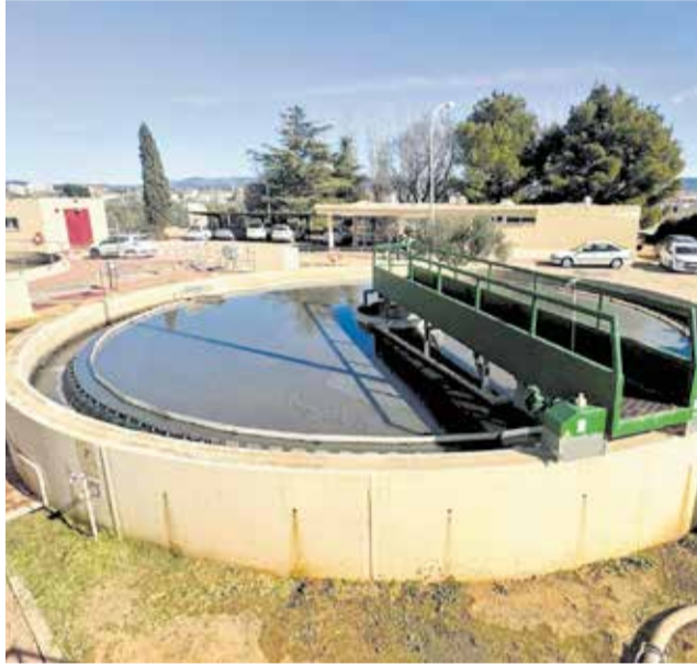
Depuradora de Utiel. / EPDA
