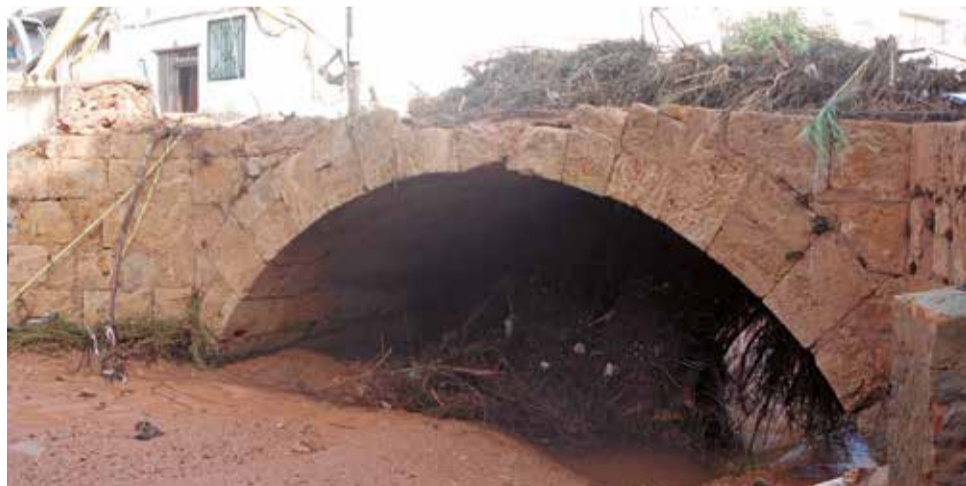
El puente afectado tras la dana de octubre de 2024. / EPDA
