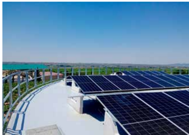
Una de las plantas fotovoltaicas. / EPDA
