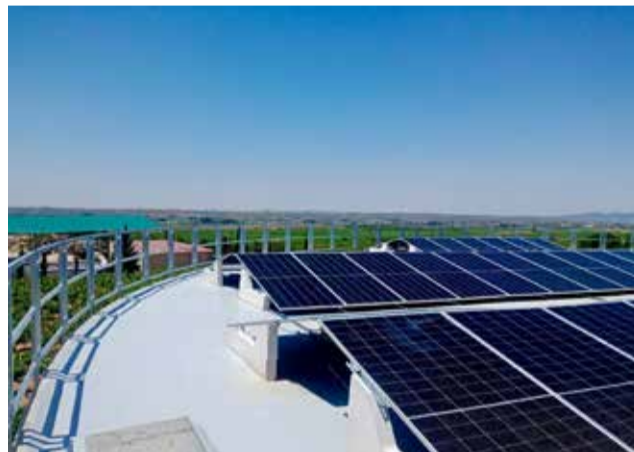
Una de las plantas fotovoltaicas. / EPDA
