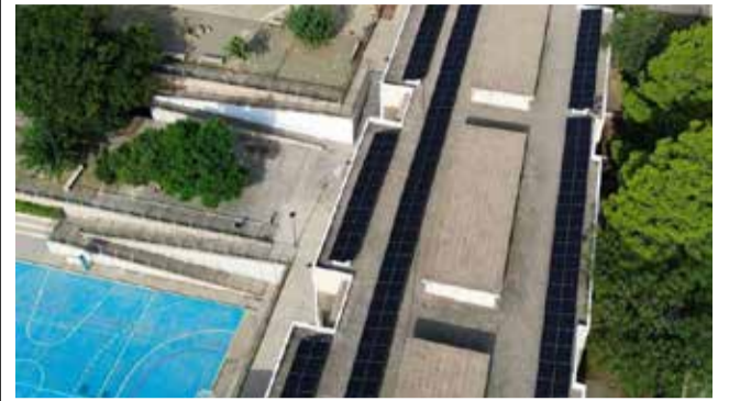
Paneles solares instalados en Altura. / EPDA
