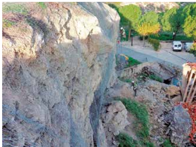
Derrumbe en el talud del Cerro. / EPDA
