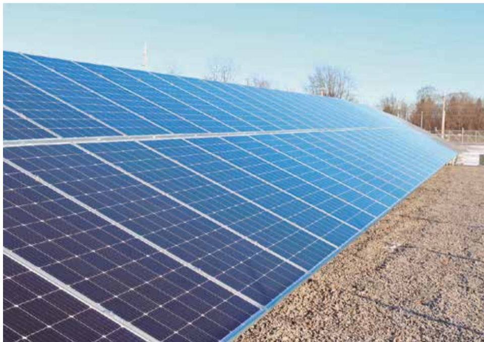
Foto archivo de una planta fotovoltaica. / EPDA
