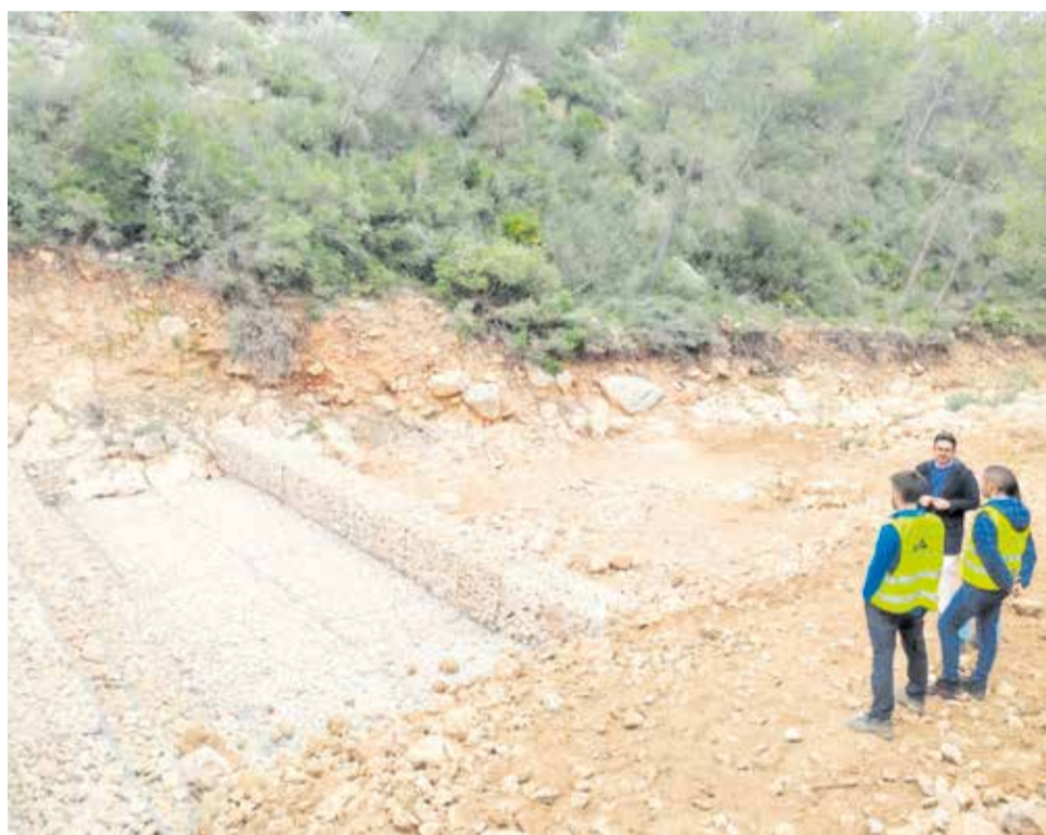
Estructura de protecció davant fenòmens meteorològics a La Llomaina. / EPDA
