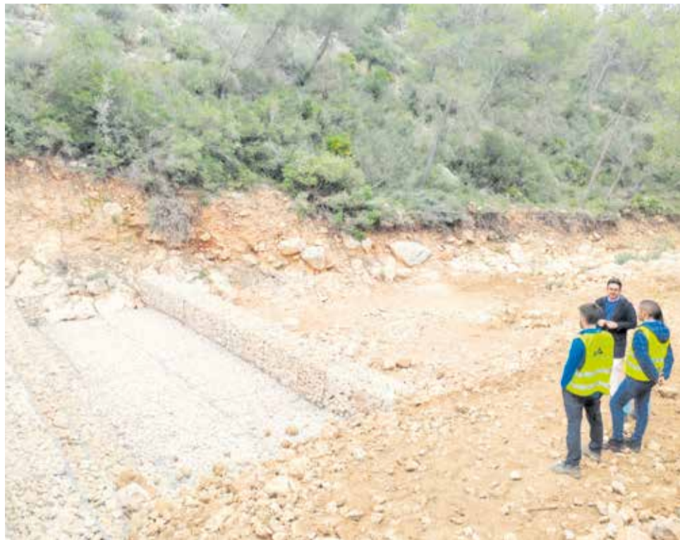
Estructura de protecció davant fenòmens meteorològics a La Llomaina. / EPDA
