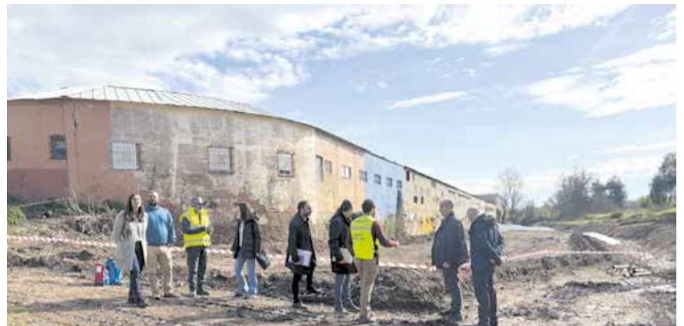
Visita del presidente y la comisionada de la CHJ a las obras en Salt de l'Aigua. / EPDA
