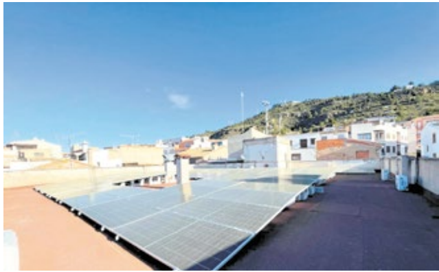
Placas solares instaladas en Castellnovo. / EPDA
