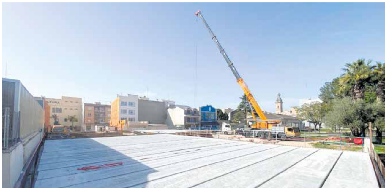
Estructura del nuevo edificio que acogerá el Hogar de los Jubilados en la Poble de Vallbona. / EPDA
