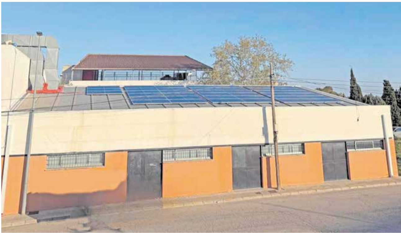
Placas solares instaladas en el Centro de los Jubilados de Benaguasil. / EPDA
