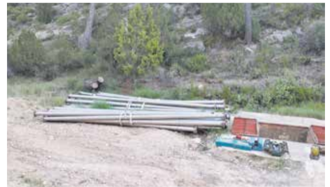
Nuevas tuberías de acero inoxidable. / EPDA
