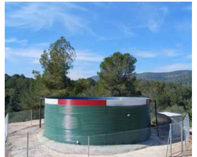
Depósito instalado en la sierra de Enguera. / EPDA
