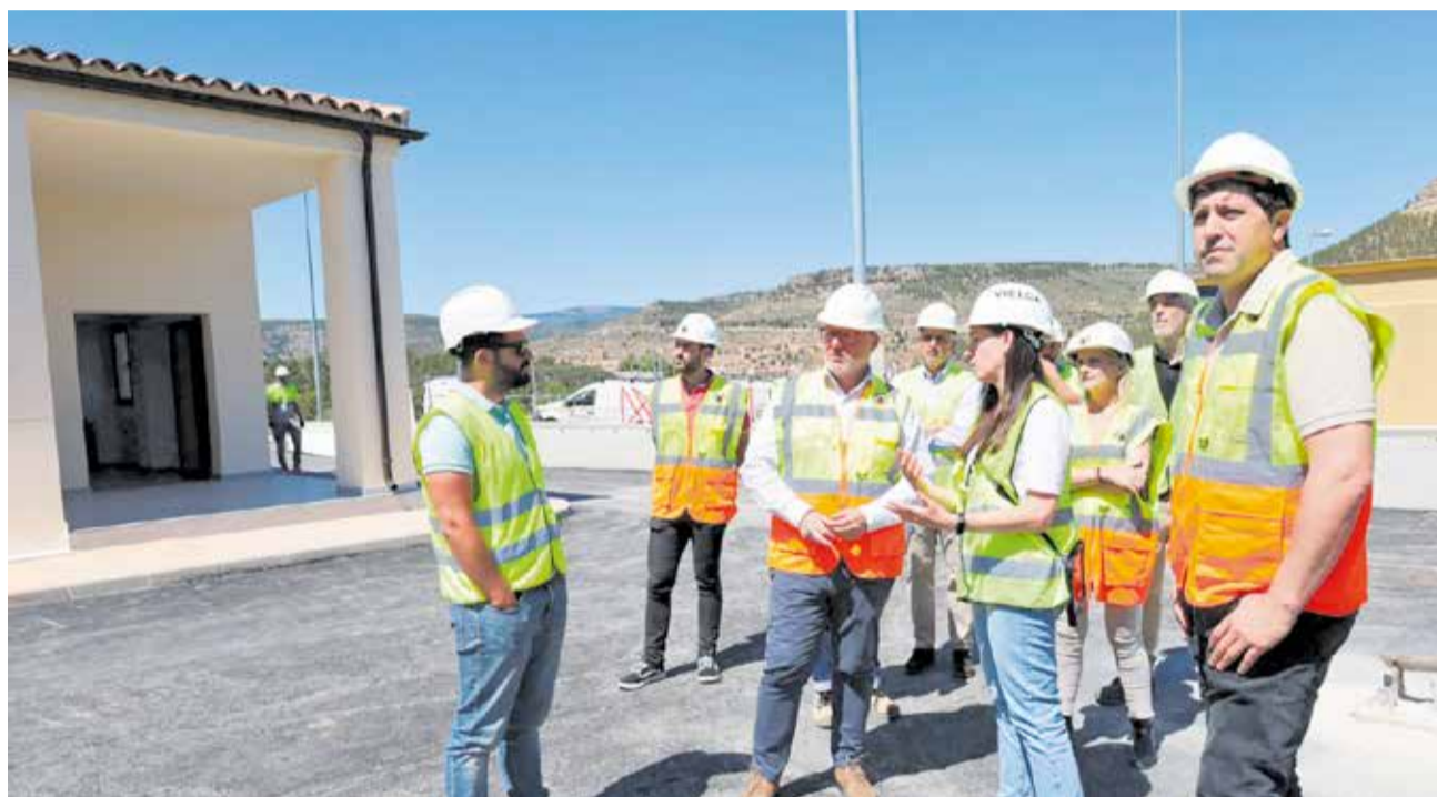
Visita institucional a las obras de la primera base de brigadas forestales. / EPDA
