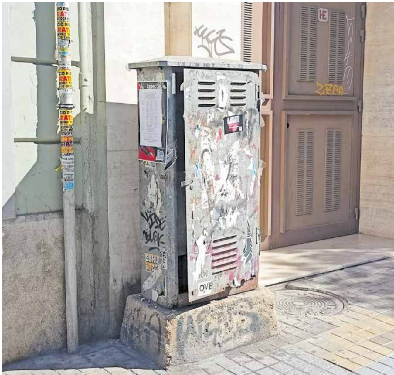
Un armario de distribución eléctrica en la calle Colón, en Valencia. / R. ESCRIG
