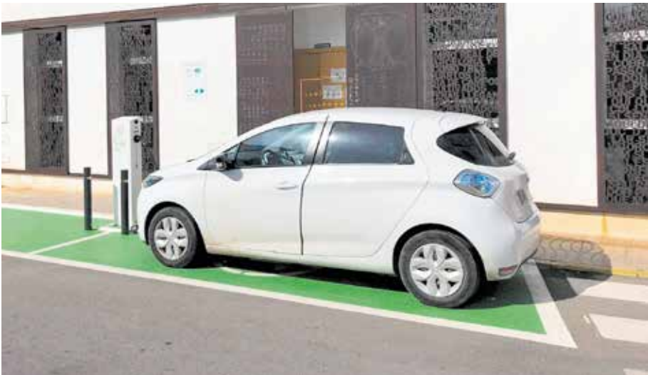
Punto de carga para coches eléctricos instalado en Rafelbunyol. / EPDA
