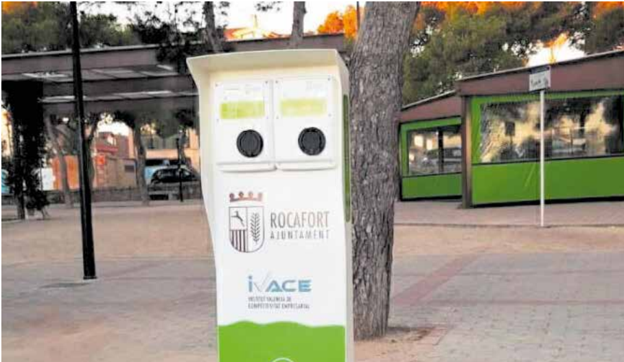
Cargador eléctrico instalado por el Ayuntamiento de Rocafort. / EPDA
