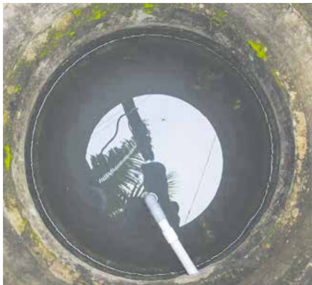
Pozo de captación de agua subterránea. / JUCUMASRU
