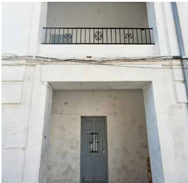
Estado actual de Casa Amelia. / EPDA
