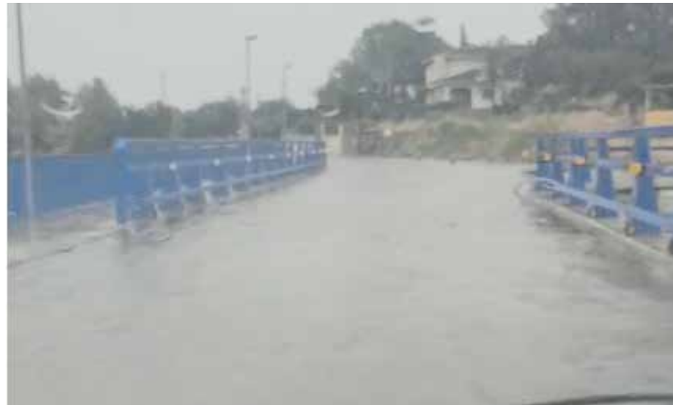
El Puente del Gallego anegado tras las últimas lluvias registradas en Chiva. / EPDA
