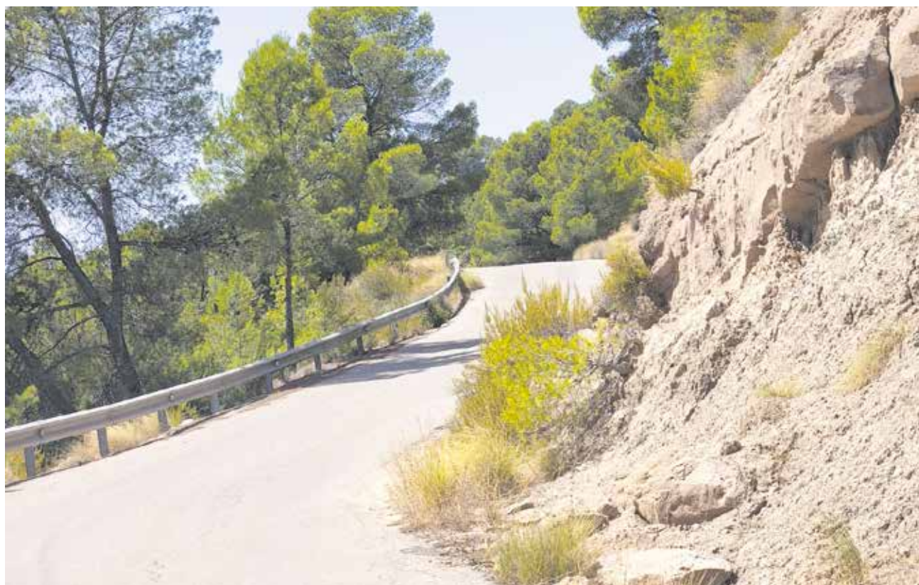
Estado actual del camino del Pansero, vía estratégica para las comunicaciones de Cortes de Pallás. / DIPUTACIÓN VALENCIANA
