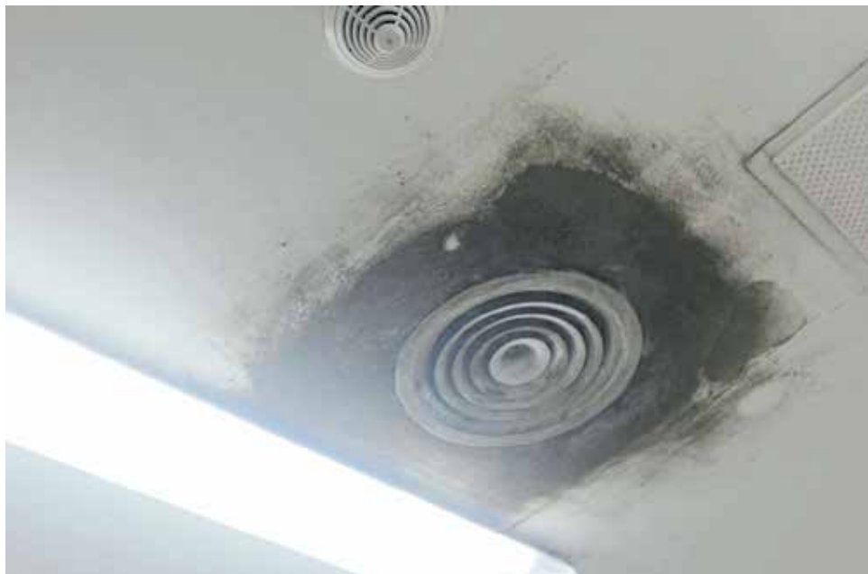
Un tros de sostre de l'Hospital de Sagunt. / CCOO
